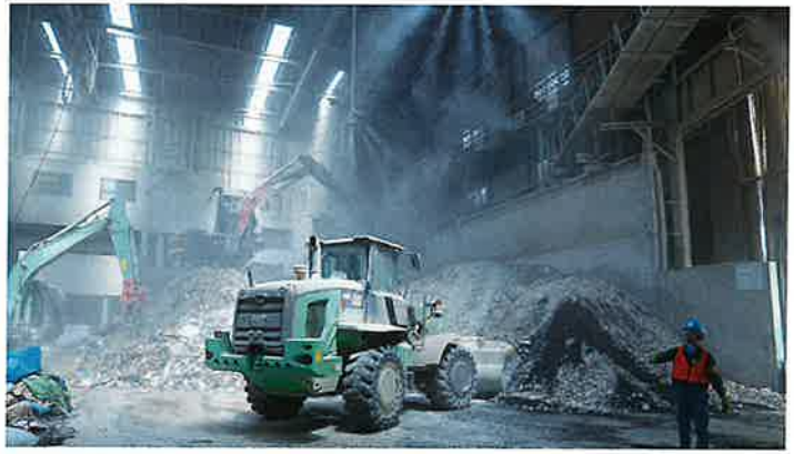
全天候型プラント。屋根には明かり取り窓を設置し、自然採光でLEDの照明点灯も節約
