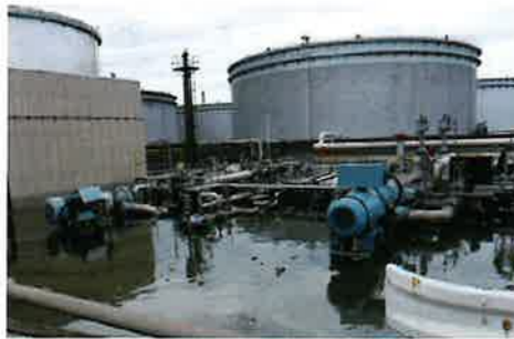
冠水した製油所敷地 (2019年10月台風)
