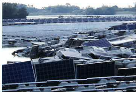
千葉県市原市水上設置型太陽光発電所損壊 (2019年9月台風)
