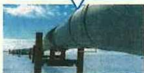
ロシア産パイプライン
