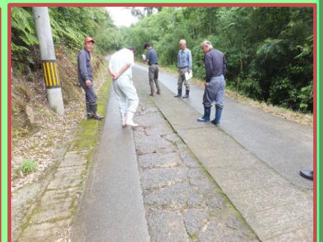
神岡の道路陥没
