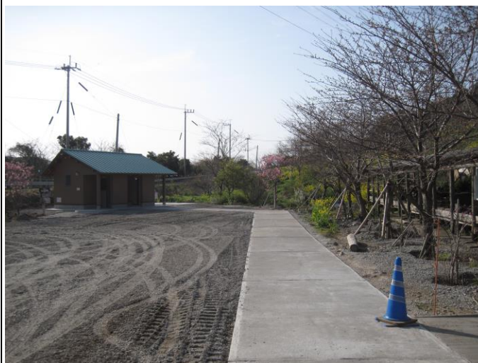
バンガロー下の駐車場の奥に設置(林道下)
